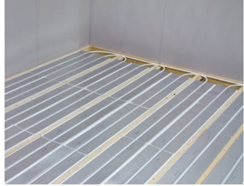
12. Installationen är klar.
