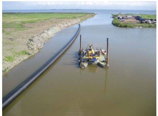
Pietari, Venäjä: jätevesipuhdistamon purkuputki. Uponor Infra toimitti hankkeeseen Weholite-putkea noin 1060 m DN/ID 1200 mm sekä hitsauspalvelut.
