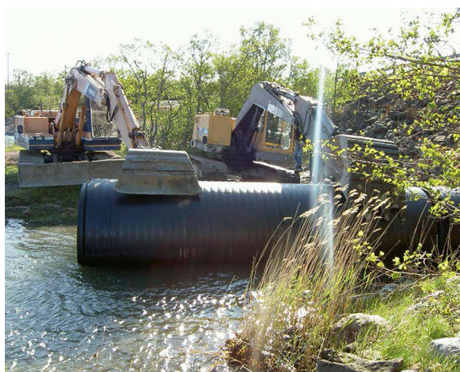
Ävabro, Ahvenanmaa: vanha peltinen tierumpu saneerattiin sujuttamalla sen sisään Weholite DN/ID 1600 mm SN4 -putki, jota asennettiin yhteensä 30 m.
