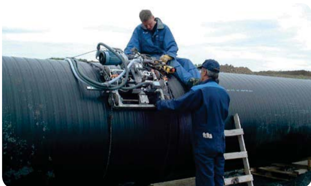
Ekstrūzijas savienojuma šuves metināšana cauruļvada ārpusē. Kvalificēts personāls un Uponor metināšanas iekārta.
