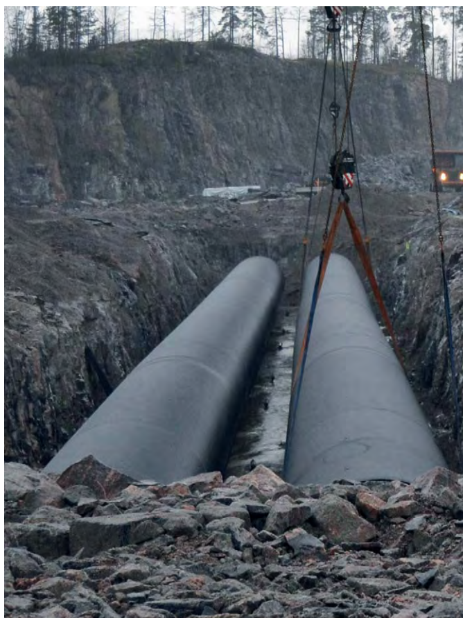
▲ Vanda, Finland: en dagvattentank för hantering av en förbränningsanläggnings/ett kraftverks regnvatten. Tanken är av Weholite-rör i dimension DN/ID 3000 mm, total längd 200 m, totalvolym 1400 m 3 .
