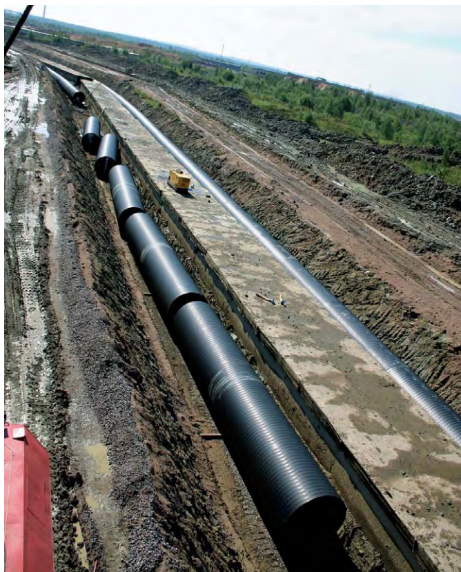
▲ S:t Petersburg, Ryssland: som utloppsledning till ett avloppsreningsverk installerades Weholite PE-rör DN/ID 2220/2000 mm. Av den totala längden på 1400 m är 200 m utloppsrör under vattnet. Weholite användes även i inledningsdelen av ledningen, för dragning under järnväg och som förlängning av gamla stål- och betongrör. Dessutom levererades flera hundra meter DN/ID 50–2000 mm Weholite- och PE-rör till byggplatsen.
