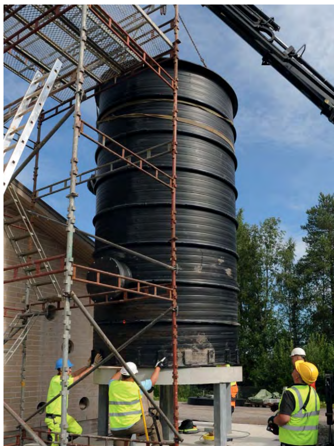
▲ Idensalmi, Finland: en värmeisolerad luftningstank avlägsnar överlopps koldioxid ur tappvattnet. Tanken DNI/D 2400 mm installerades på betongplatta som färdig konstruktion.
