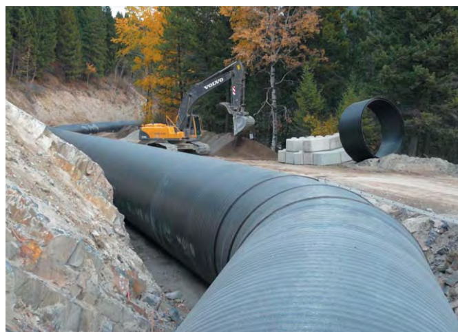
▲ British Columbia, Kanada: Aberfeldie Run-of-River: i samband med en sanering av ett vattenkraftverk installerades DN/ID 3300/3000 mm Weholite-rör, längd 855 m, tryck 1,5 bar. Rörledningen omfattar även 14 böjar och 2 brunnar DN/ID 1200 mm.
