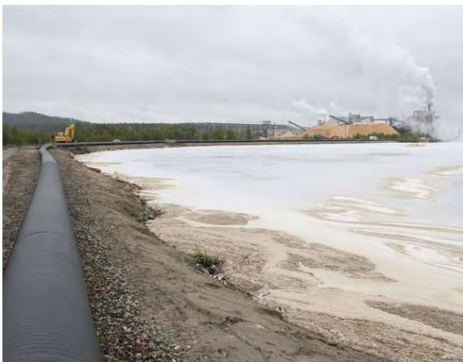
◀ Stora Enso, Kemijärvi, Finland: utloppsledning från en anläggning för aktivt slam som används för avloppsrening Weholite DN/ID 700/788 mm SN4. Utloppsröret leder det reade vattnet till sjön Kemijärvi. Längden på röret är 1050 meter. Röret är anslutet till pumpstationsbyggnaden med flänskoppling. Förankringen utfördes med 6 m 3 betongvikter som förhindrar värmerörelser. Röret installerades av tekniska skäl som ytinstallation.
