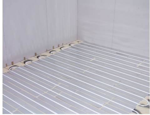
26. Installationen är klar.
