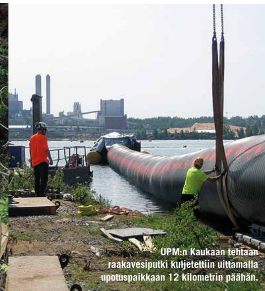
Metsä Boardin Simpeleen tehtaan raakavesiputki kulkee kapeilla kallioseinämillä, padon läpi ja järvenpohjassa.
