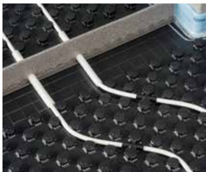
Giunto di dilatazione attraversato da tubazioni in corrispondenza di una porta
