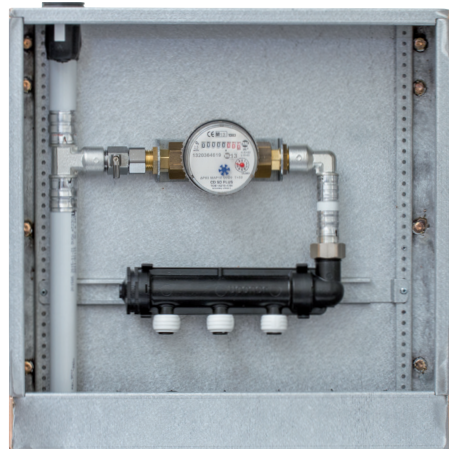
Bild: Fördelare i tappvattenskåp
