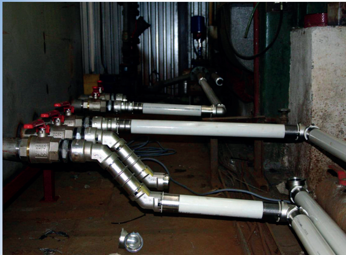
Připojení k nádrži s chladící kapalinou
