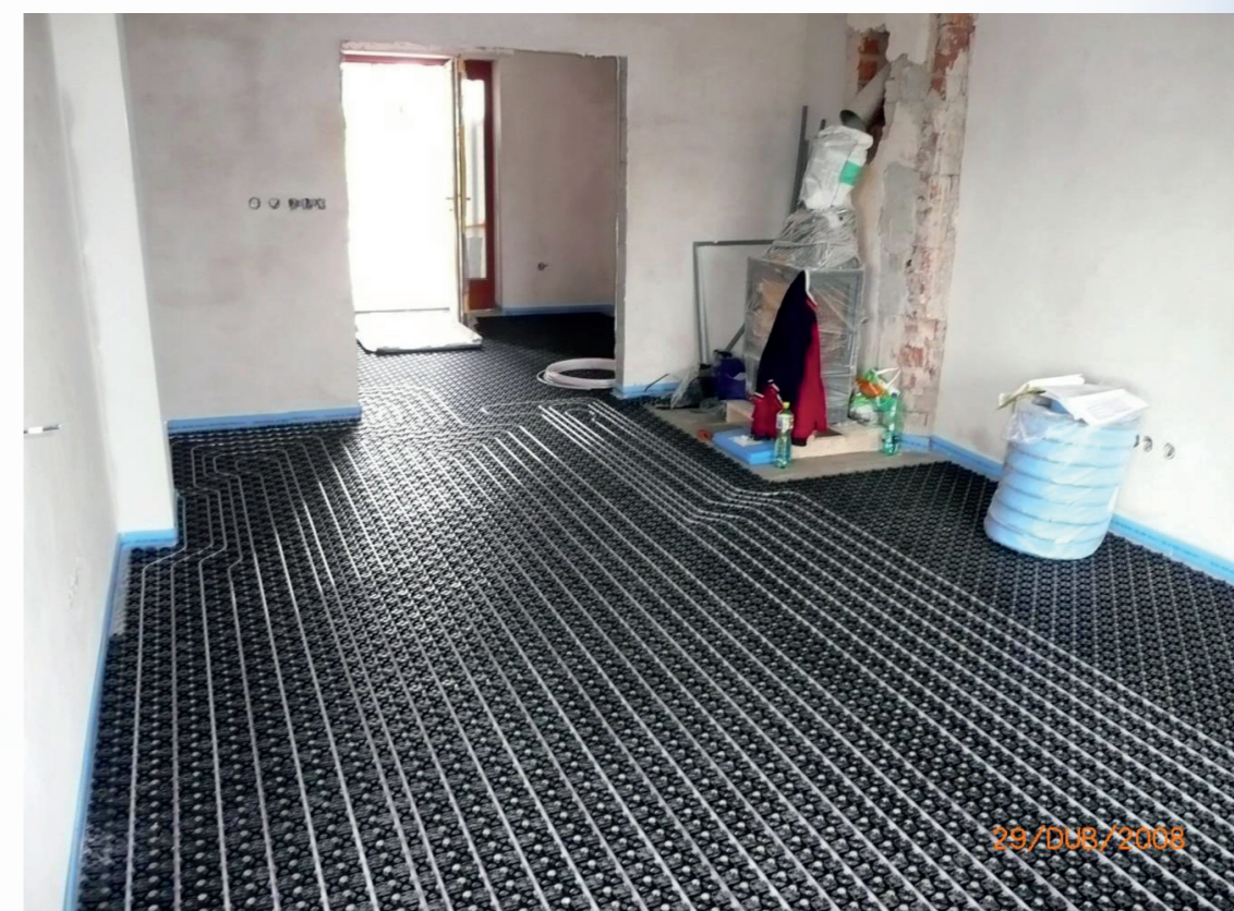
Připojení okruhů podlahového vytápění na rozdělovač/sběrač
