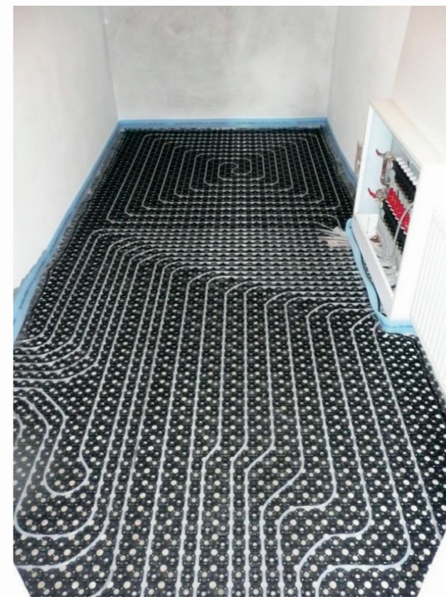
Technická místnost s instalovaným rozdělovačem/sběračem
