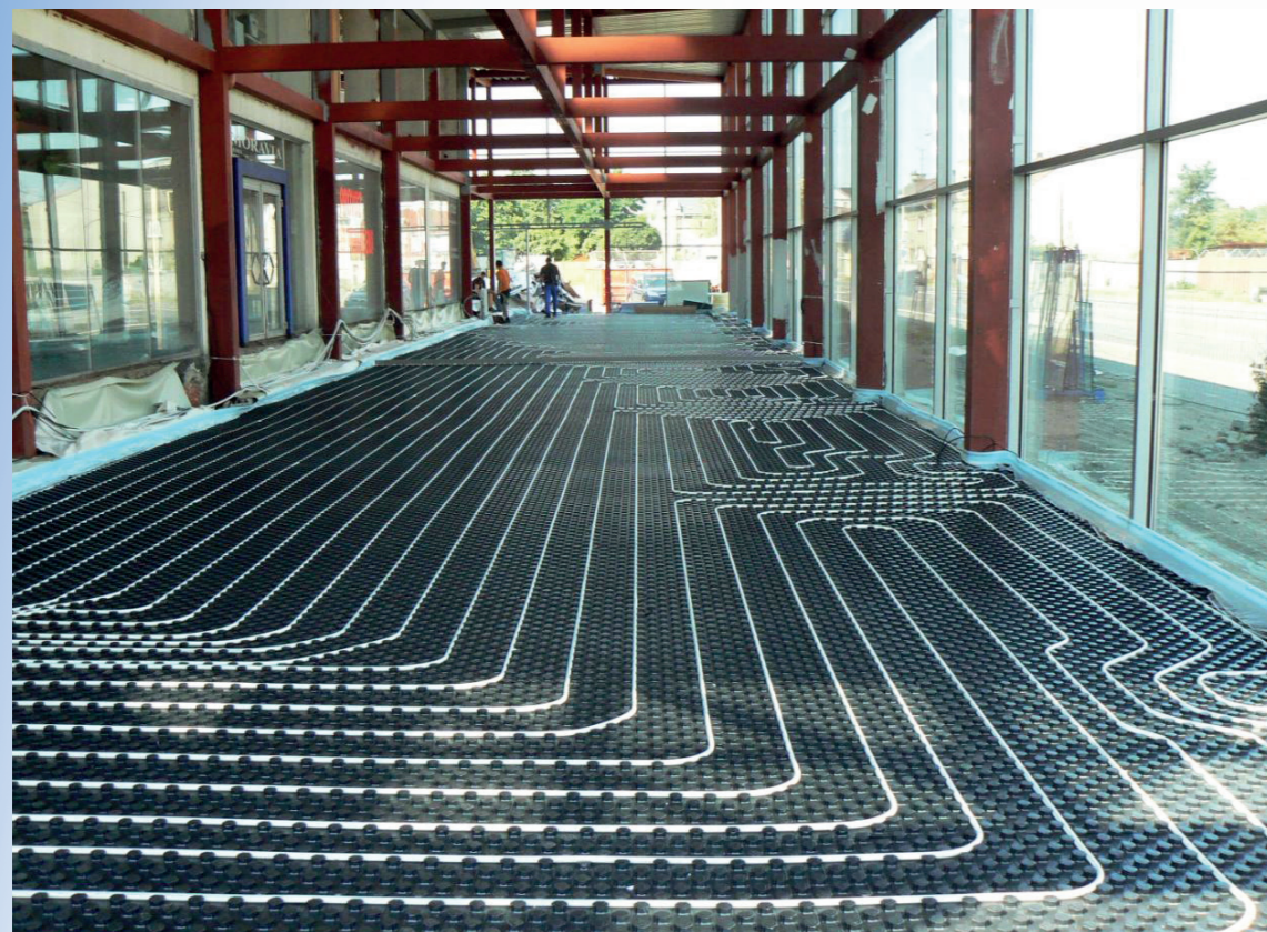
Stejný prostor s instalovanými smyčkami
