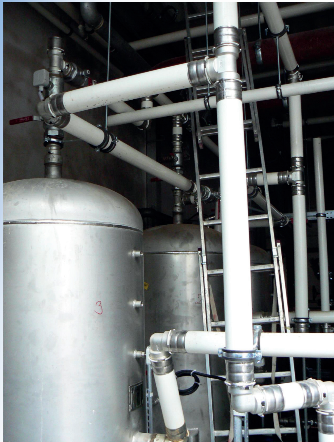
Potrubní rozvod k akumulčním nádržím
