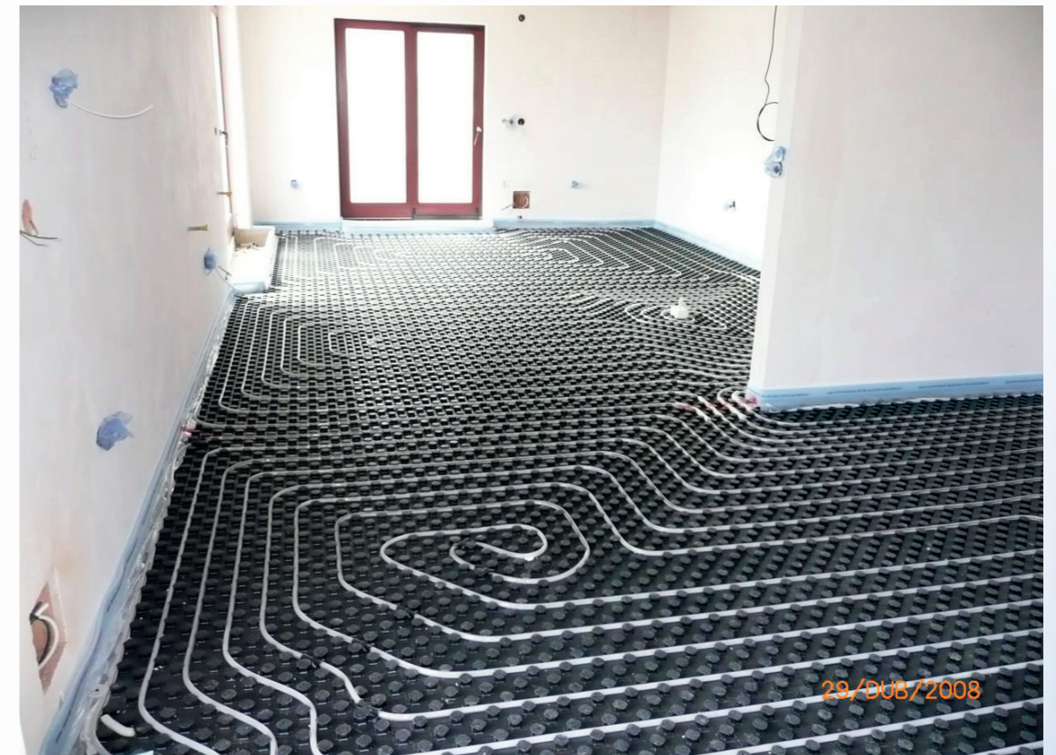
Smyčky podlahového vytápění
