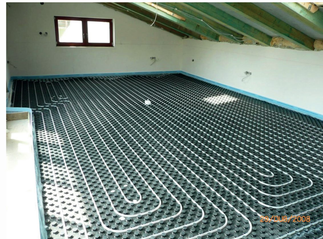
Rozvod okruhů podlahového vytápění v podkroví RD
