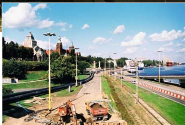
Fot. 2. Ul. Jana z Kolna. Zgrane rurociągi przygotowane do wciągnięcia do przewiertu pod rz. Odrą
