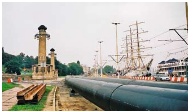
Fot. 3. Ul. Jana z Kolna. Zgrzane rurociągi przygotowane do wciągnięcia do przewiertu pod rz. Odrą
