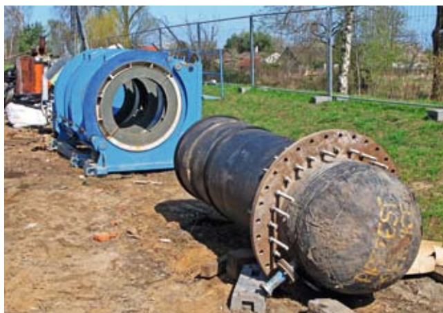
Fot. 6. Głowica do wykonania próby ciśnienia rurociągów do przewiertów
