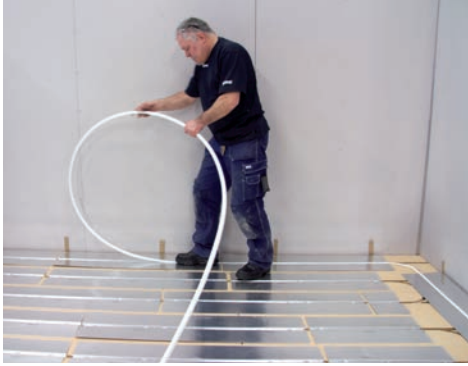
15. Trampa ner röret i plåtarna enligt slingritningen. Om du har röret i en båge framför dig underlättas monterandet.
