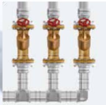
Intercettazione impianti secondari
