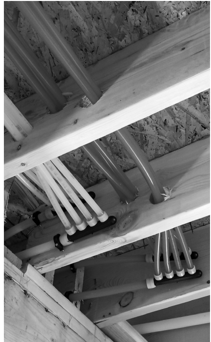
Figura 5-7: Tubería AquaPEX de Uponor en agrupaciones
