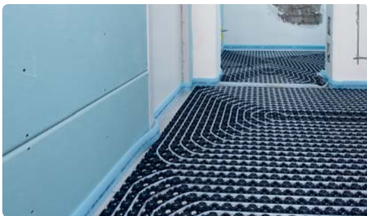
Przykładowa renowacja - system ogrzewania Uponor Minitec
