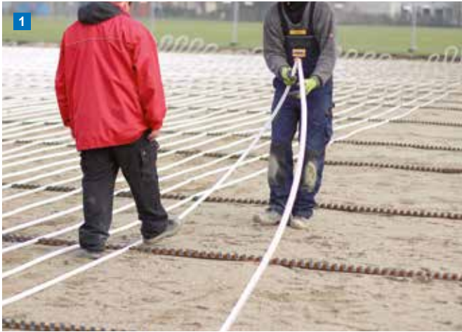
Na przygotowanym podłożu należy ułożyć szyny nośne oraz rury systemu Uponor Meltaway w obliczonym rozstawie.
