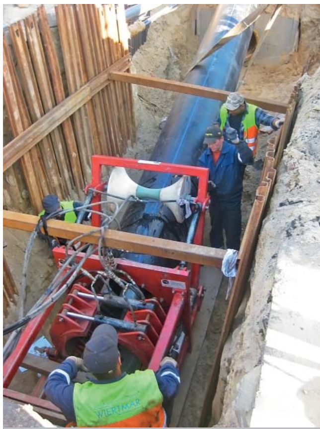
Fot. 4. Głowica wraz z rurą PE przechodzącą przez zwężkę
