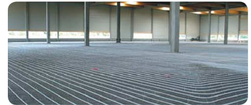
Centro de distribución piezas Airbus de 20.000 m 2 . Hamburgo (Alemania)
