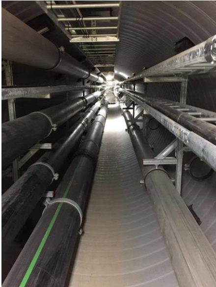
Figur 2. Kulvertrörets innandömen där ledningsnäten är upphängda.
