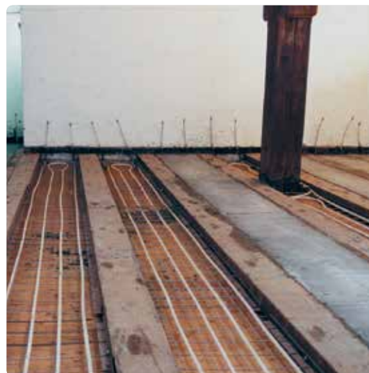
Dopasowana na wymiar instalacja pomiędzy dwiema belkami sufitu.
