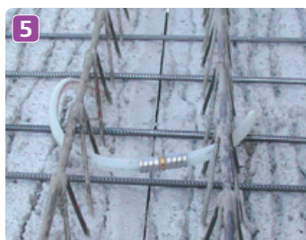
Na stavenisku sú vyústené už len ukončenia potrubí z modulov Contec ON, ktoré sa navzájom prepoja a pomocou nerozoberateľného spôsobu spájania Uponor Q&E s pripojením na hlavnú distribučnú sústavu.
