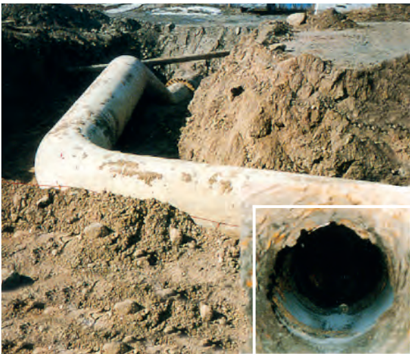
Vanha 800 mm teräsputki saneerauksen tarpeessa.
