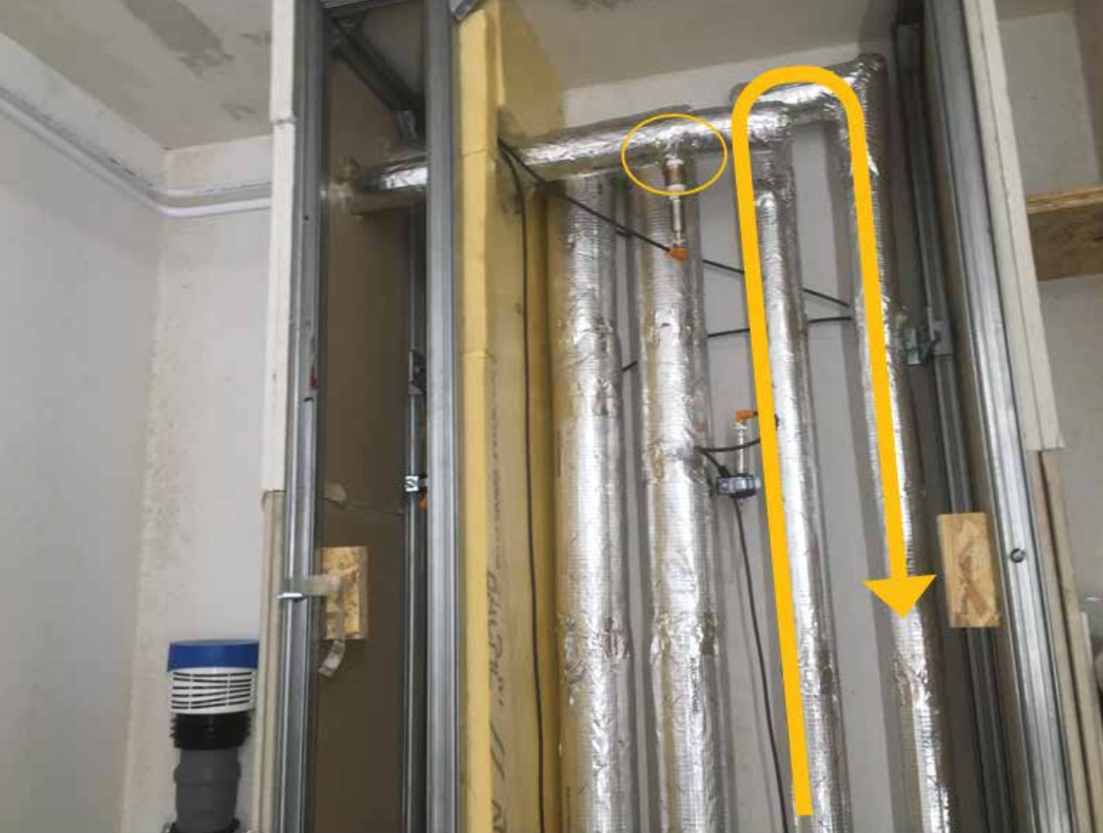
Abb. 2 An jedem Abzweig einer zirkulierenden Warmwasserleitung ergibt sich während Stagnationsphasen systematisch ein hohes Risiko für Legionellenwachstum aufgrund der langen Verweilzeit des Wassers im Abzweig bei ungünstigen Temperaturen.
