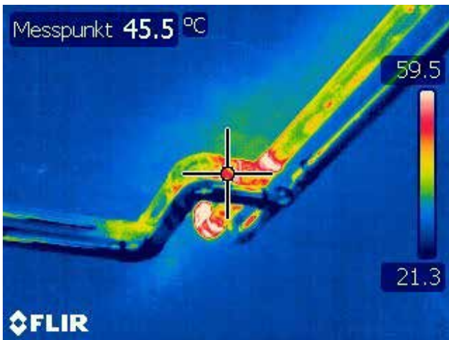
Der Effekt des unkontrollierten Aufheizens von stagnierenden Warmwasserabzweigen im Infrarot.
