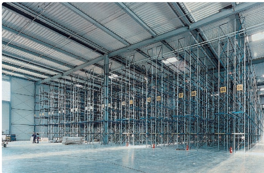
Průmyslové podlahové vytápění Uponor o rozloze 20 000 m 2 umístěné ve skladu, Hückelhoven, Německo
