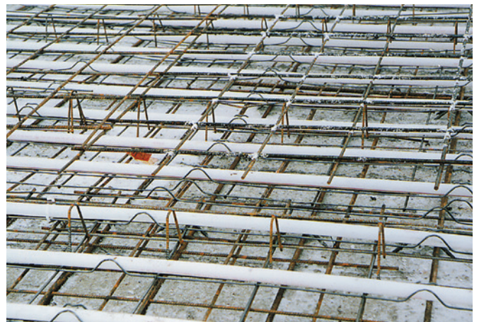
Contec Module auf Gitterträger aufgelegt.
