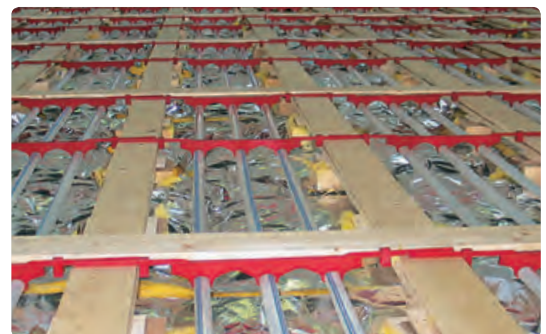
Flächene lastischer Sportschwingboden mit integrierter Uponor Schwingbodenheizung
