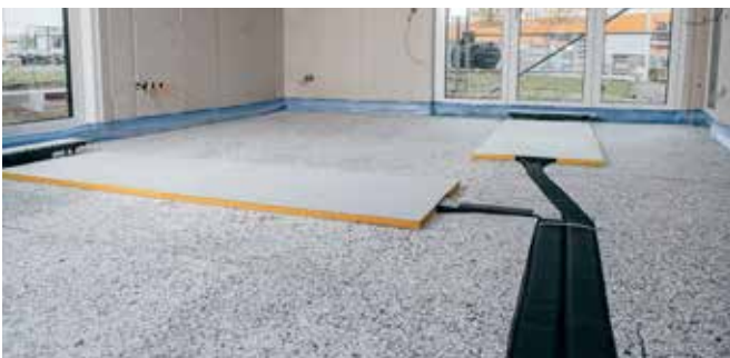
Fertig montiertes Comfort Air System
