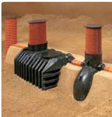
Fotoet viser opstilling med sandfangsbrønd, udskiller og prøvetagningsbrønd.
