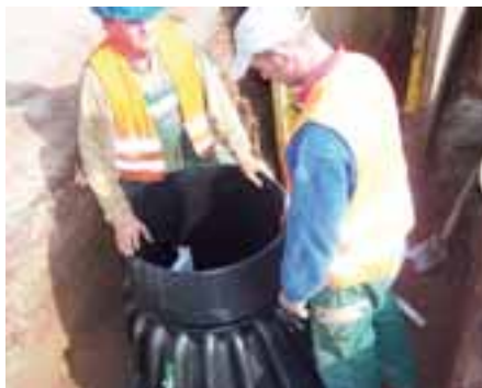
Uppföringsrör på kona
