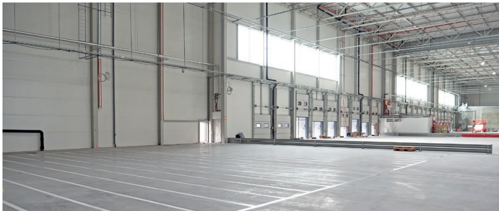
Uponor Quattro-järjestelmä ohjaa lämmön juuri sinne, missä sitä tarvitaan, esimerkiksi lastaustaskujen edustalle. Kuva: Markus Lintu
