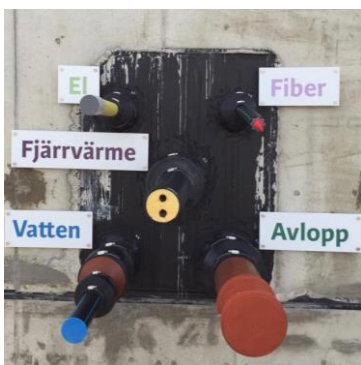
Figur 21: Servisplatta med servisledningar genom kammarvägg sett utifrån
