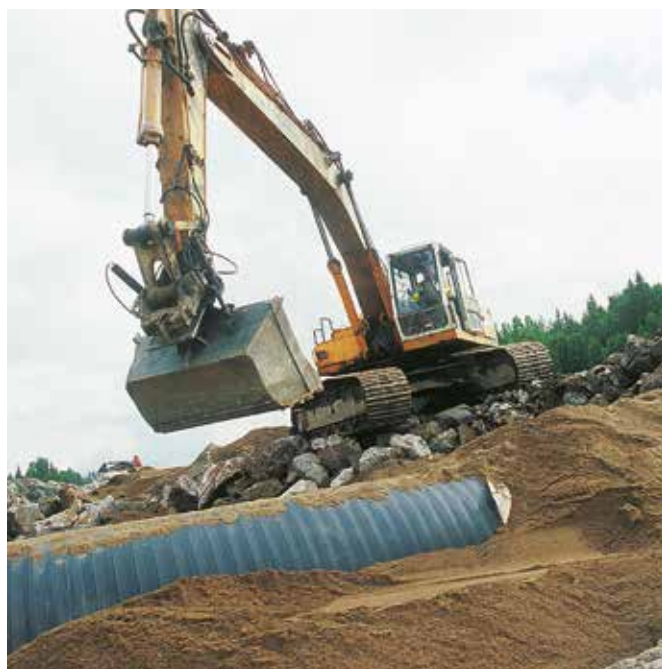
Riksväg 4 Lahti – Heinola, Finland: Syftet med detta omfattande projekt var att minska trafikköerna mellan Lahti och Heinola, och för att öka trafiksäkerheten. Weholite-rör DN/ID 400–1 800 mm med gängkopplingar levererades till projektet. Rören installerades dels i öppna diken och genom relining. Installationen utfördes i team om en till två personer och en grävmaskin. En oberoende rapport om långsiktig deformation av Weholite-rörtrummor DN/ID 1 600 mm SN4 har sammanställts av VTT. Denna rapport finns som VTT-S-11213-07, 19.12.2007.
