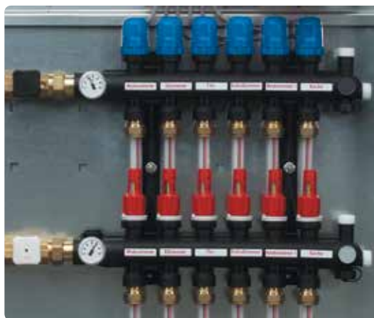
Połączenia w rozdzielaczu z rurami Uponor PE-Xa oraz złączkami zaprasowywanymi
