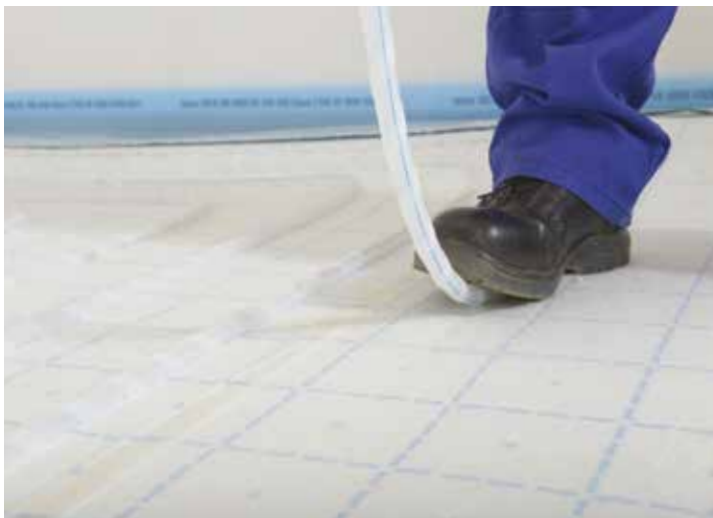
La posa avviene con una leggera pressione del piede sul tubo. L'attrito fa sì che non si sposti più dalla sua posizione
