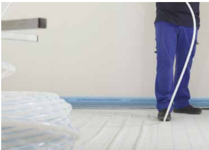
Successivamente si riposiziona il tubo fissandolo con la consueta pressione del piede, potendo contare sulla stessa aderenza della prima posa
