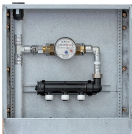
Bild: Fördelare i tappvattenslåp
