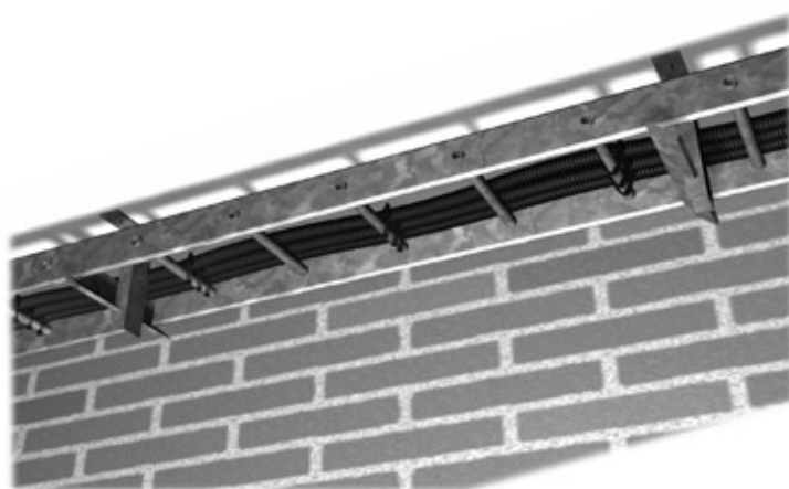
Prowadzenie rur w peszlu lub w izolacji w korytkach gdzie wydłużenia są kompensowane poprzez wyboczenie się.
