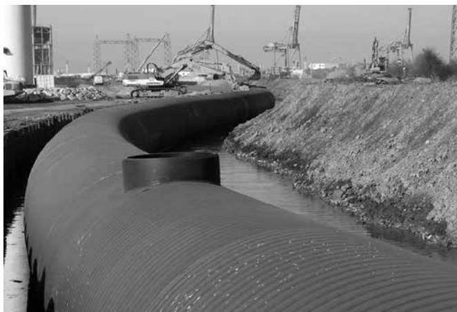
Rurociągi technologiczne i przemysłowe, (wody chłodzącej, gospodarka wodno-ściekowa)
