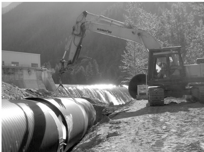
Rurociągi derywacyjne w elektrowniach wodnych
