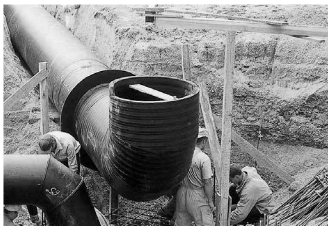
Rurociągi na obiektach, np. oczyszczalniach ścieków
