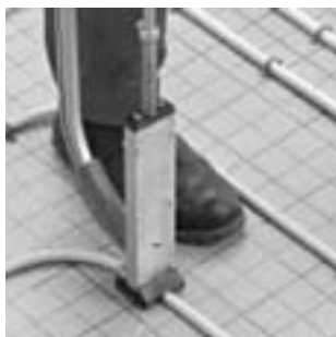
Rys. 35. Montaż rur grzejnych przy pomocy tackera i spinek.
