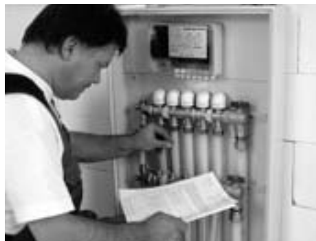
Rys. 42. Po wylaniu szlichty i uruchomieniu systemu, ustaw nastawy wstępnie na zaworach regulacyjnych lub przepływomierzach wg obliczeń w projekcie technicznym.
