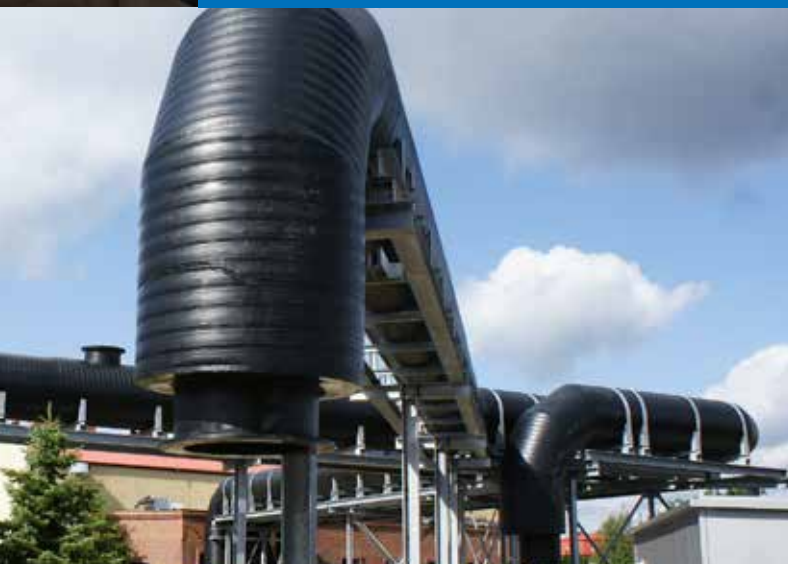
Rurociągi deodoryzacyjne, Polska
