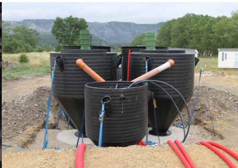
Elementy oczyszczalni ścieków, Francja
