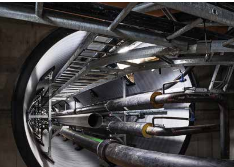
Tunel wieloprzewodowy, Szwecja
