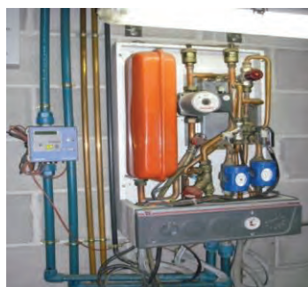
Subestação de DH de Molins de Rei "La Granja". Fonte Ditriclima
